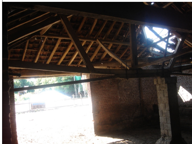
De oude koestal aansluitend op de historische bebouwing heeft ernstige gebreken. Het dak is dringend aan vernieuwing toe, muren vertonen bsten van centimeters breed.
