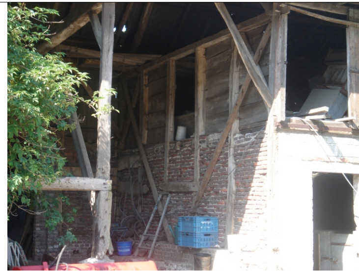
De berging is gebouwd boven een bestaande kelder. De muren zijn combinaties van baksteen, hout en golfplaten.
