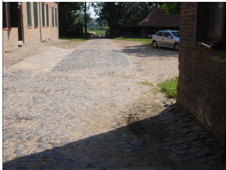
Verhardingen op het erf bestaan uit kasseien, bakstenen en grint. De kasseiweg langs het woonhuis toont enkele verzakkingen.
