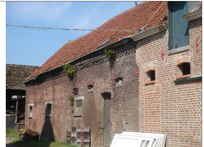
Het gedeelte aansluitend op het woonhuis is dringend aan restauratie toe.
